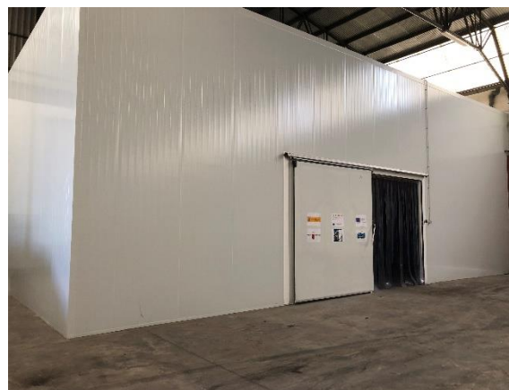
◀ Instalación frigorífica. Fuente: Integral
